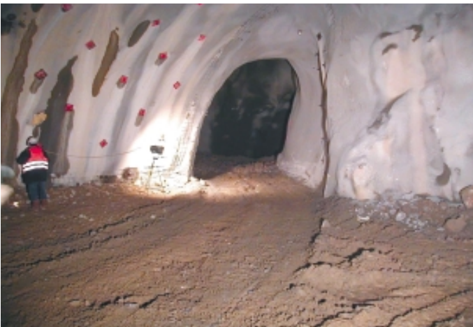
Obr. 2 Jeskyně zastížené během ražby tunelu Irlahüll Fig. 2 Cavities encountered during the Irlahüll tunnel excavation
