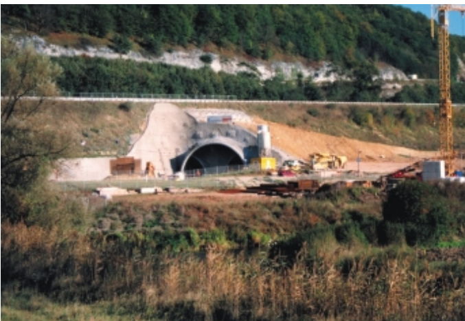
Obr. 4 Pohled na severní portál tunelu Irlahüll Fig. 4 A view of the Irlahüll tunnel North portal
