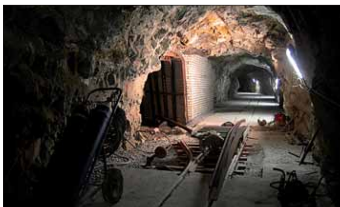
Obr. 3 Odbočení k akumulátorovně, stav před dokončením Fig. 3 Turning to battery charging station, situation before finishing
