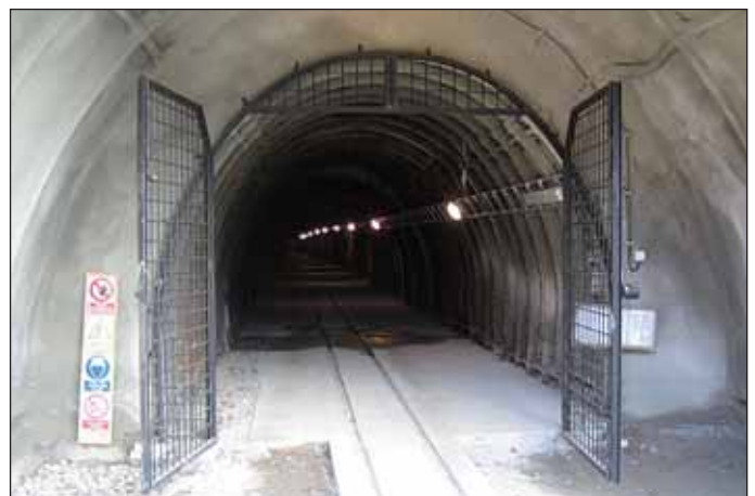
Obr. 10 Portál štoly po osazení mřížových vrat v únoru 2007 Fig. 10 Gallery portal after installation of grated gate in February 2007
