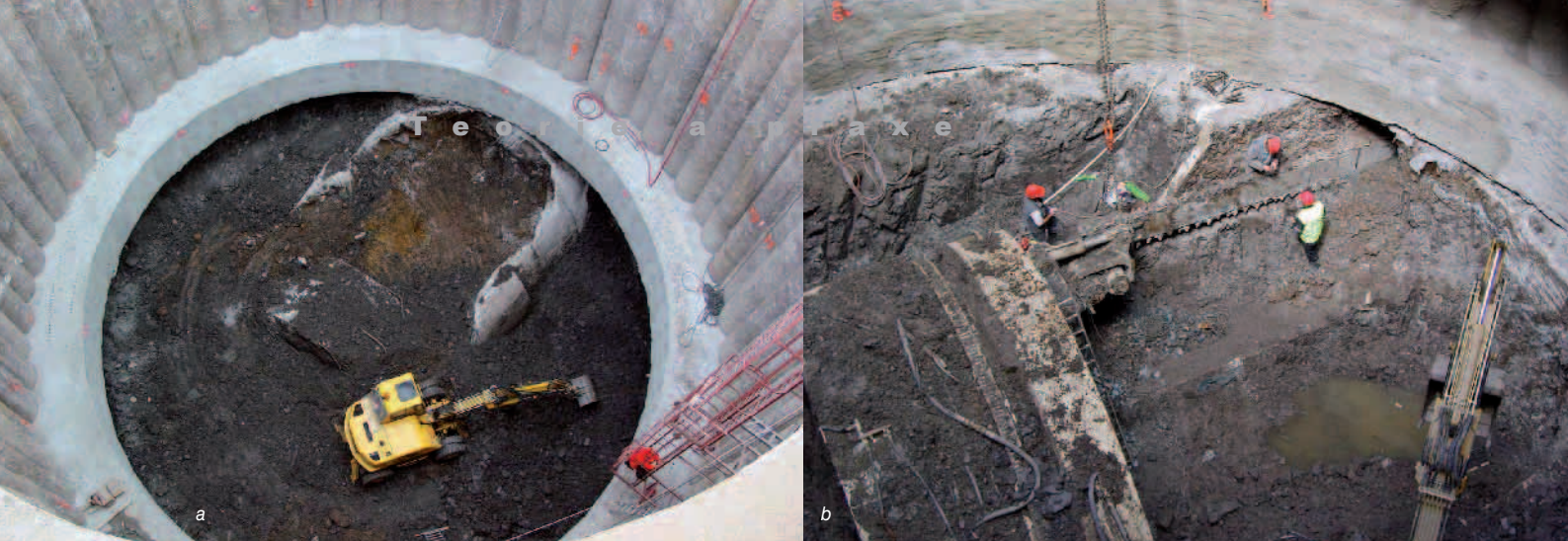
Obr. 10 a, b: Hloubení v oblasti tunelu a zavaleného vrubovacího stroje, a – původní předklenby, b – stroj Perforex
