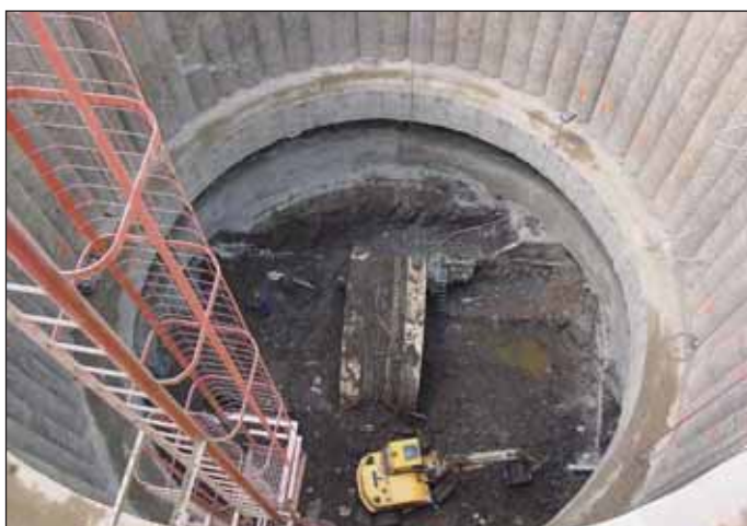
Foto 4 Hloubení šachty v oblasti zavaleného stroje Perforex Photo 4 Excavation in the vicinity of the buried Perforex machine
