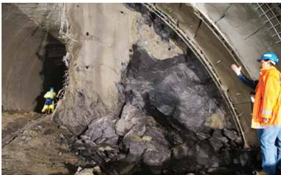
Obr. 14: Nestabilita čelby při nepříznivém sklonu puklin
