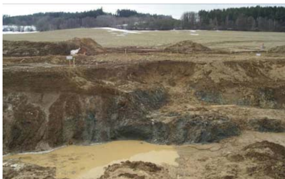
Obr. 4 Sesuv zvodnělého eluvia na západním svahu v oblasti výjezdového portálu
