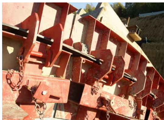
Obr. 6 Detail čela s vloženým tesnicím pásem pro utěsnění spáry mezi bloky betonáže
