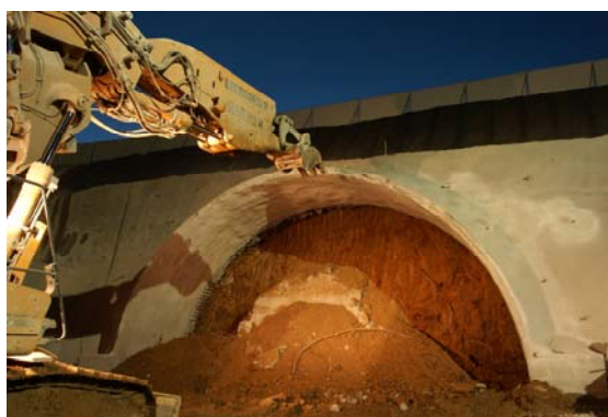
Obr. 3 Výjezdový portál Olbramovického tunelu se zcela zvětralým eluviem a minimálním nadložím
