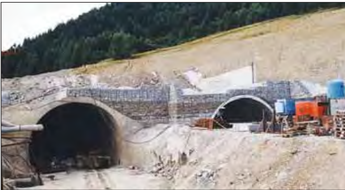
Obr. 18 Přitížení paty svahu východního portálu tunelu Branisko Fig. 18 Surcharging of the toe of the slope at the eastern portal of the Branisko tunnel
