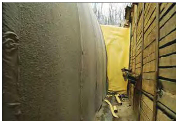
Obr. 3 Omezený prostor ve stavební jámě Komořany tunelů stavby 513 Fig. 3 Constricted space in the Komořany construction trench for the PCCR 513 tunnels
