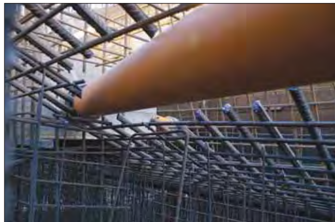
Obr. 9 Přerušování výztuže při průchodu drenáže ostěním Fig. 9 Cutting out of reinforcement bars for the passage of drainage through the lining
