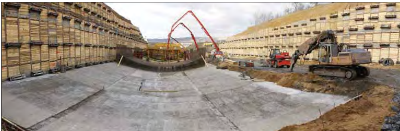
Obr. 4 Postup výstavby ve stavební jámě Komořany Fig. 4 Construction procedure in the Komořany construction trench
