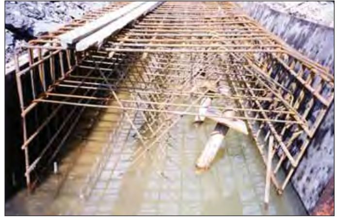
Obr. 17 Podchycení základových patek prefabrikované klenby Fig. 17 Underpinning of footings of the precast vault
