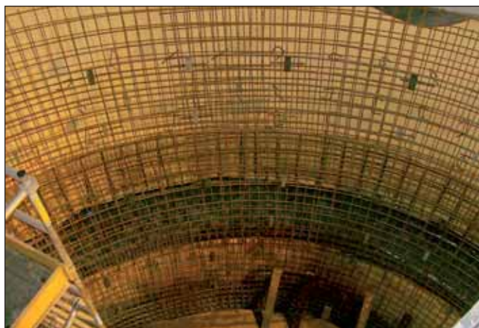
Obr. 11 Standardní vyztužení definitivního ostění šachty – síť KARI Fig. 11 Standard reinforcement of the final shaft lining – KARI mesh
