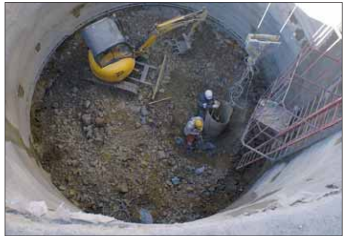
Obr. 4 Umístění vrtu DN800 mm na dně vzduchotechnické šachty Fig. 4 Location of the DN800mm borehole at the ventilation shaft bottom
