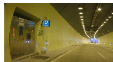
SOS výklenek. The niche with SOS equipment.
