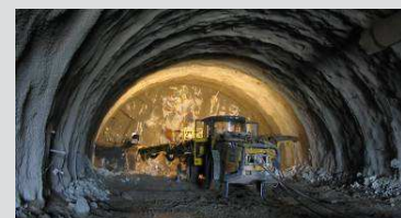
Navrtávání čelby pro umístění tržavin. Drilling of the tunnel face for blasting.
