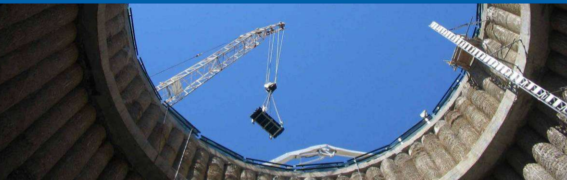
Šachta tunelu Březno pro vytažení zavaleného stroje Perforex a vybudování únikového východu (průměr 21 m, hloubka 35 m). Celkem 70 pilot průměru 1,18 m a délky 40 m. Březno tunnel shaft for removal of buried Perforex machine after tunnel collapse and for the emergency exit (21m in diameter, 35m deep). 70 piles, 1,18m in diameter, 40m length.
